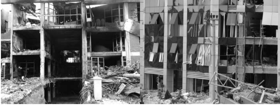
Şekil-4: 3 Şubat 2011 tarihinde Ankara – OSTİM’de meydana gelen patlamalarda hasar gören üretim tesisleri
